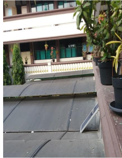
Gambar 2. Penempatan panel surya di atap kanopi lantai dua SMP N 264 Jakarta Barat (Tampak samping).
